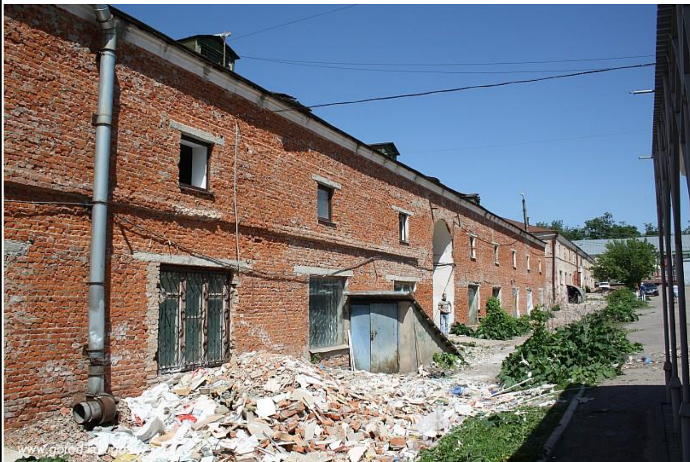
Фото2. Вид дворового фасада по состоянию на 2009 год, поздние железобетонные перемычки над окнами, следы поздних закладок оконных проемов
